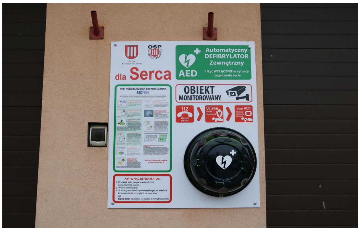
Zdj.7. Urządzenie AED zainstalowane na ścianie remizy OSP w Radomyślu nad Sanem [1]
